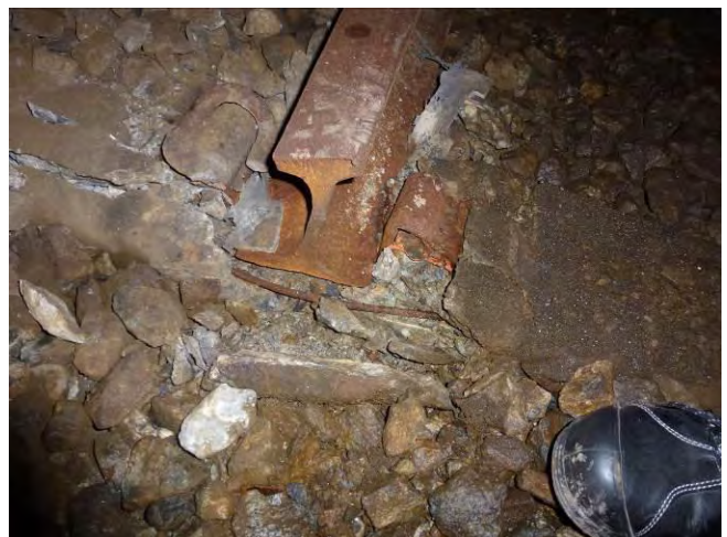
Figura 36 - Punto di rottura della rotaia al km 5+710 lato Paola (si noti la deformazione del troncone e il segno di un colpo sulla parte destra del fungo)
