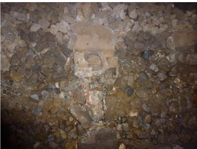
Figura 41 - Condizione di traversa e appoggio in corrispondenza dello spezzone di rotaia distaccato al km 5+710 (1ª traversa da Castiglione verso Paola)
