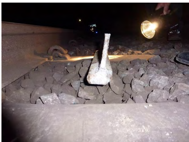
Figura 51 – Parte della rotaia rotta (5)
