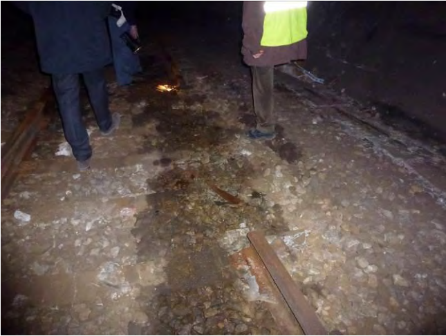
Figura 27 - Punto di rottura della rotaia al km 5+710
