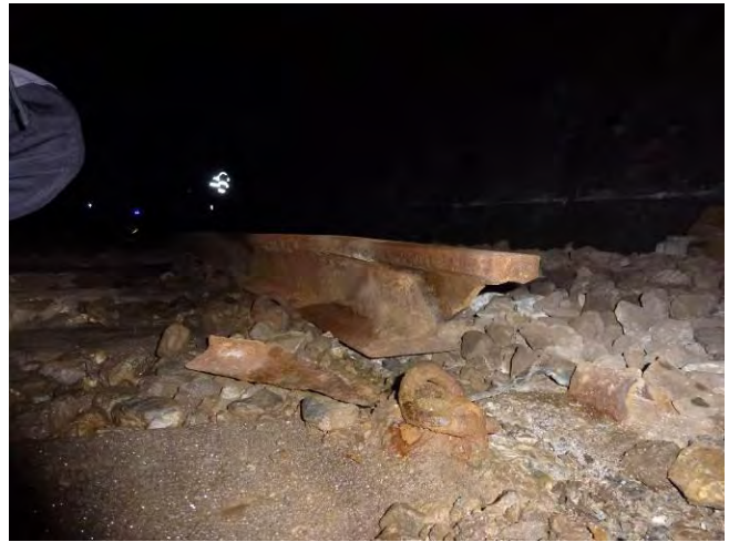
Figura 38 – Punto di rottura della rotaia al km 5+710 lato Castiglione e frammento di rotaia rotta (4)
