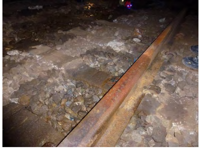
Figura 61 - Vista d'insieme rotaia destra smt in corrispondenza del punto di distacco dello spezzone di rotaia sinistra smt al km 5+710
