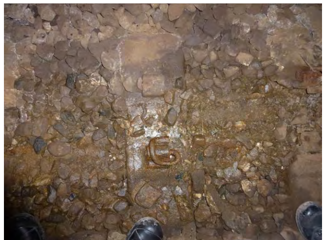
Figura 42 - Condizione di traversa e appoggio in corrispondenza dello spezzone di rotaia distaccato al km 5+710 (2ª traversa da Castiglione verso Paola)
