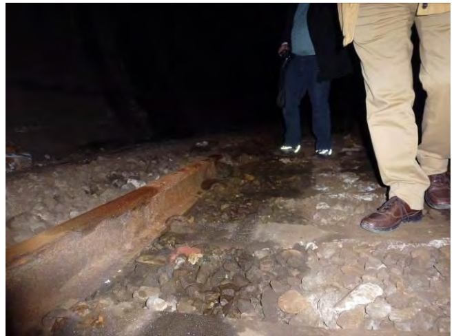
Figura 34 - Punto di rottura della rotaia al km 5+710, vista in direzione Paola
