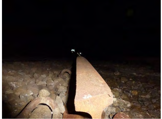
Figura 32 – Punto di rottura della rotaia al km 5+710, vista in direzione Paola
