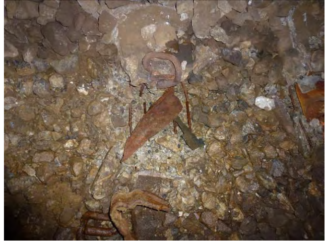
Figura 44 - Condizione di traversa e appoggio in corrispondenza dello spezzone di rotaia distaccato al km 5+710 (4ª traversa da Castiglione verso Paola) e frammento della rotaia rotta (8)
