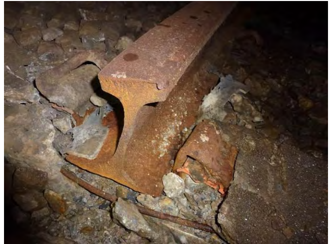
Figura 30 - Punto di rottura della rotaia al km 5+710, vista in direzione Paola
