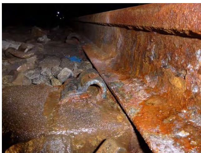
Figura 59 - Rotaia destra smt in corrispondenza del punto di distacco dello spezzone di rotaia sinistra smt al km 5+710
