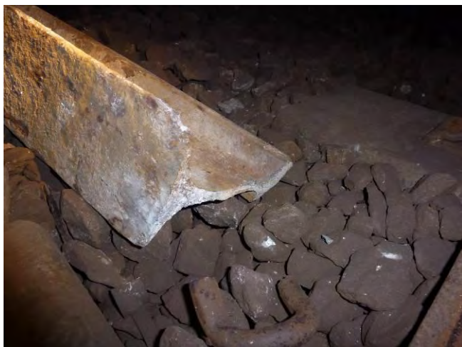
Figura 55 - Parte della rotaia rotta (7)
