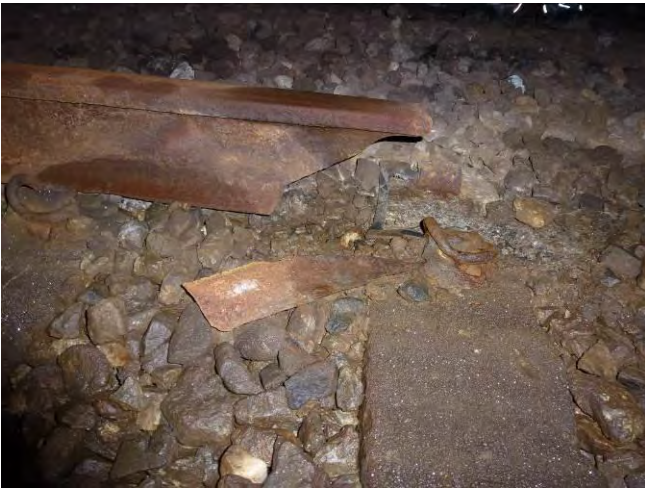
Figura 37 – Punto di rottura della rotaia al km 5+710 lato Castiglione e frammento di rotaia rotta (4)
