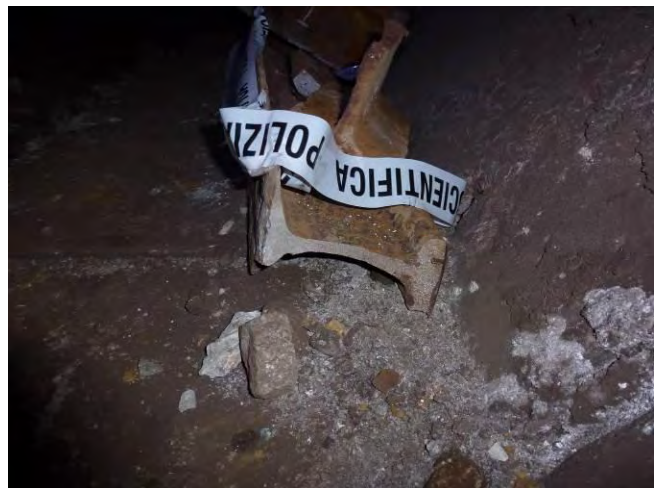
Figura 48 – Parti della rotaia rotta (1) (2) e (3)
