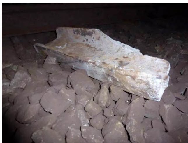
Figura 57 - Parte della rotaia rotta (7)
