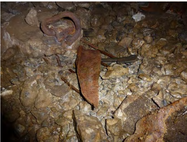
Figura 45 - Condizione di traversa e appoggio in corrispondenza dello spezzone di rotaia distaccato al km 5+710 (4ª traversa da Castiglione verso Paola) e frammento della rotaia rotta (8)
