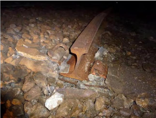
Figura 29 - Punto di rottura della rotaia al km 5+710, vista in direzione Paola
