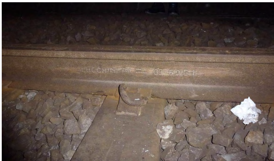
Figura 5 - Marcatura rotaia in prossimità del punto di svio
