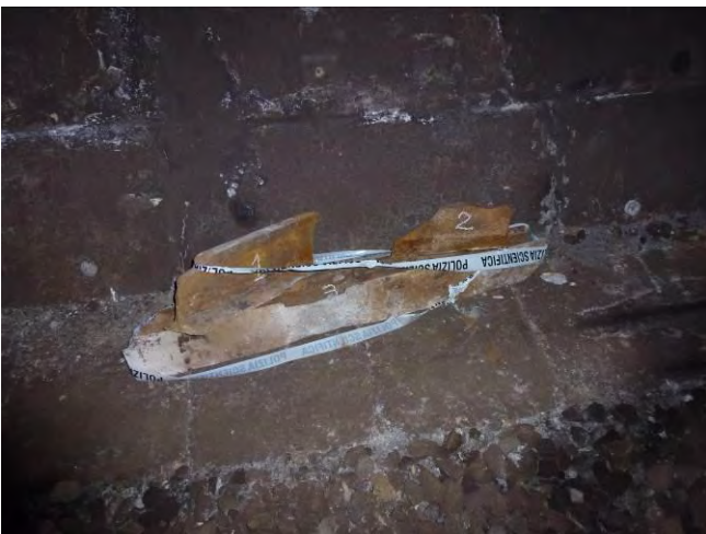
Figura 47 – Parti della rotaia rotta (1) (2) e (3)
