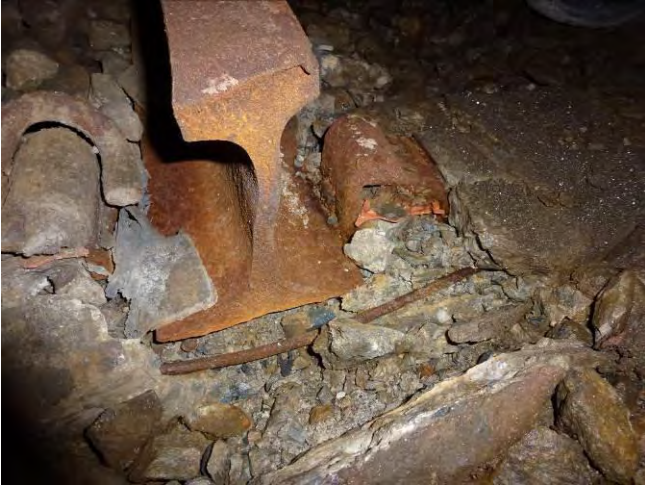
Figura 31 – Punto di rottura della rotaia al km 5+710, vista in direzione Paola
