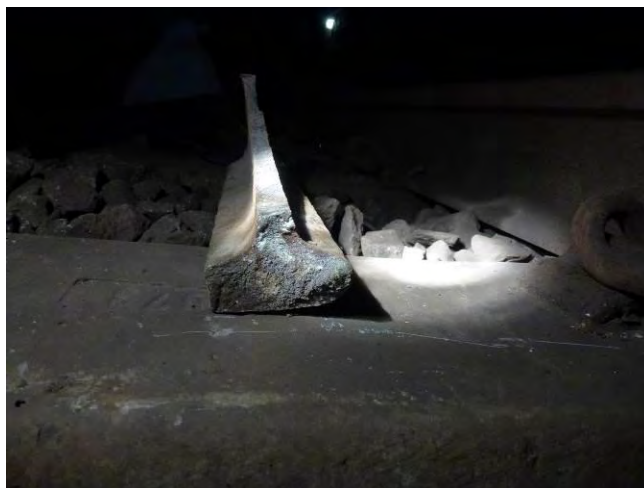
Figura 50 – Parte della rotaia rotta (5)
