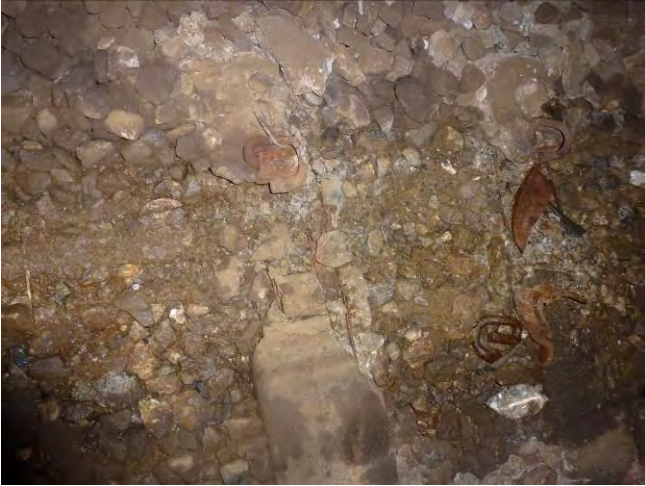
Figura 43 - Condizione di traversa e appoggio in corrispondenza dello spezzone di rotaia distaccato al km 5+710 (3ª traversa da Castiglione verso Paola)
