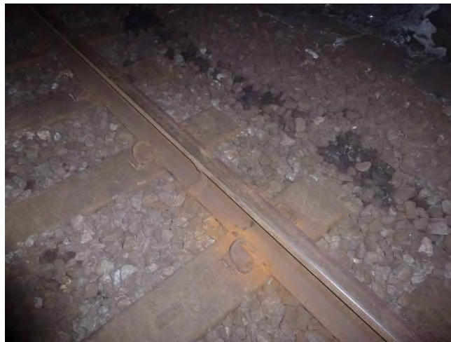
Figura 62 - Saldatura sulla rotaia sinistra smt pochi metri prima del punto di rottura della rotaia al km 5+710
