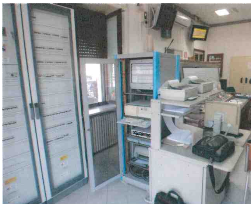
Figura 47 – Rack PdC RTB di Priverno - Fossanova
